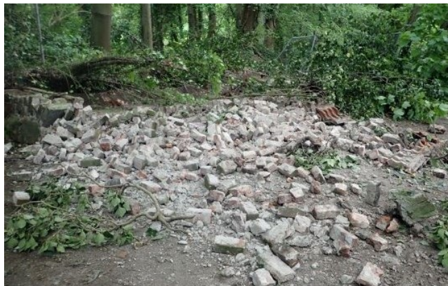
Le mur effondré du Walckiers (mai 2021) Pierre Vandystadt – Copyright © 2021 CEBE-MOB
